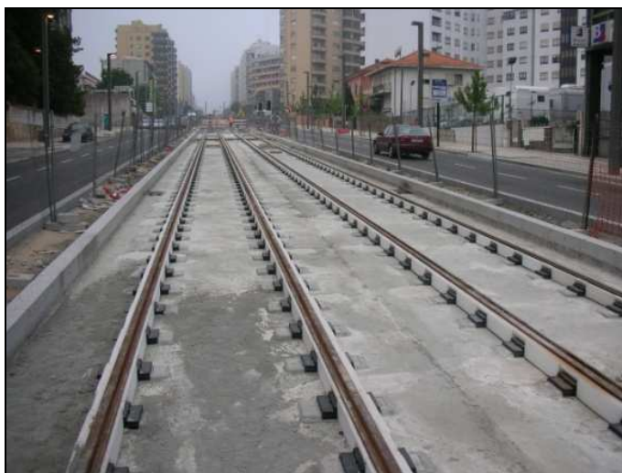
Figura 10. Capuchones de protección sobre las sujeciones de carril
