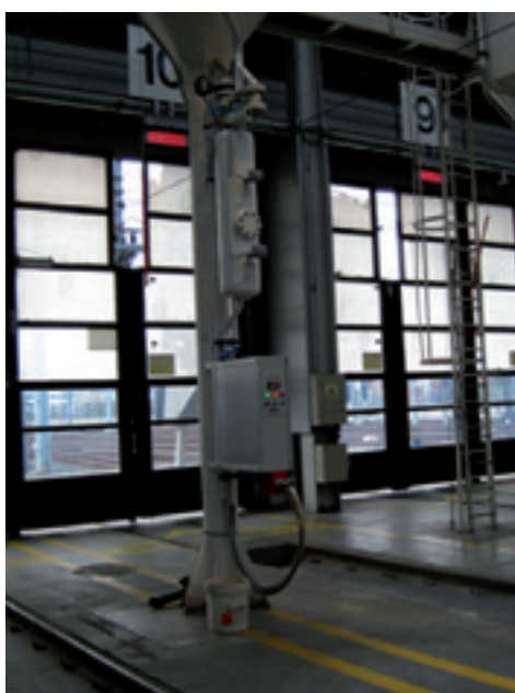
Sistema de transporte y aspiración de carga de arena Taller de Ariz
