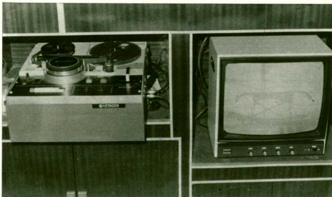
5 Este monitor de televisión permite la observación de pantógrafo y catenaria. Las imágenes son registradas en magnetoscopio.
