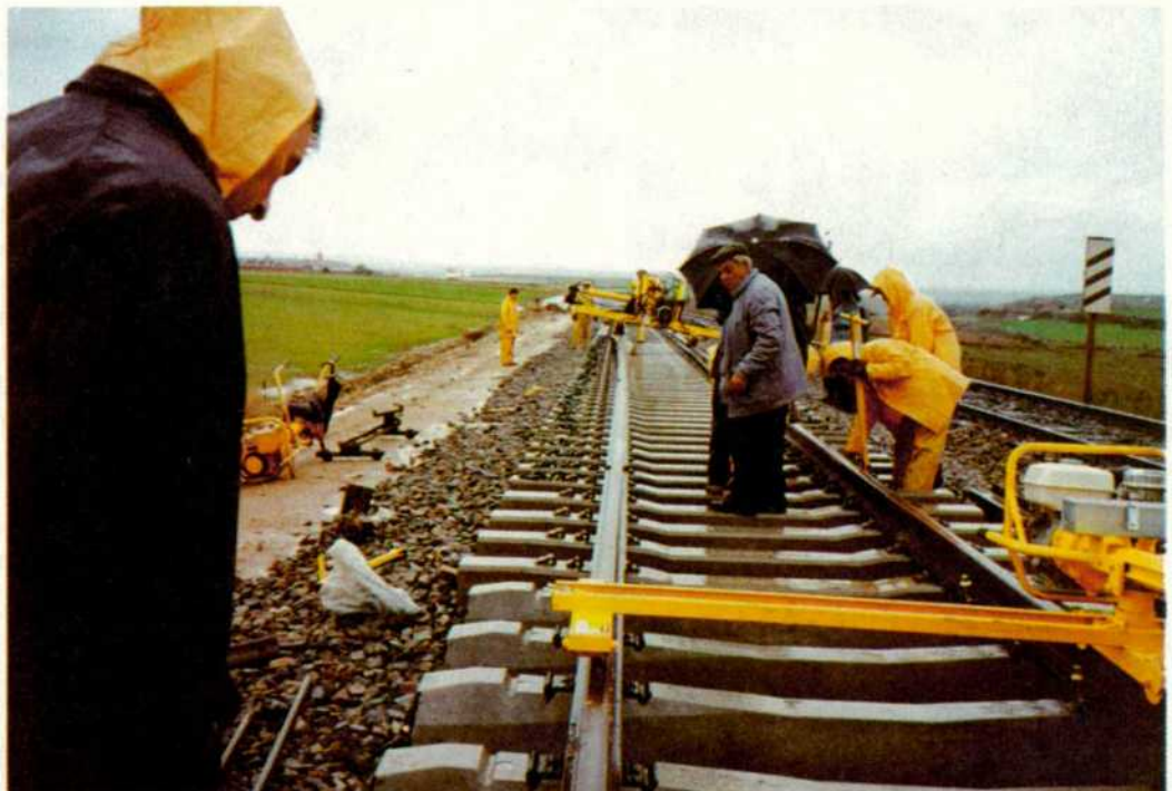
Ensayo de los métodos de transformación del ancho Renfe al ancho internacional.
